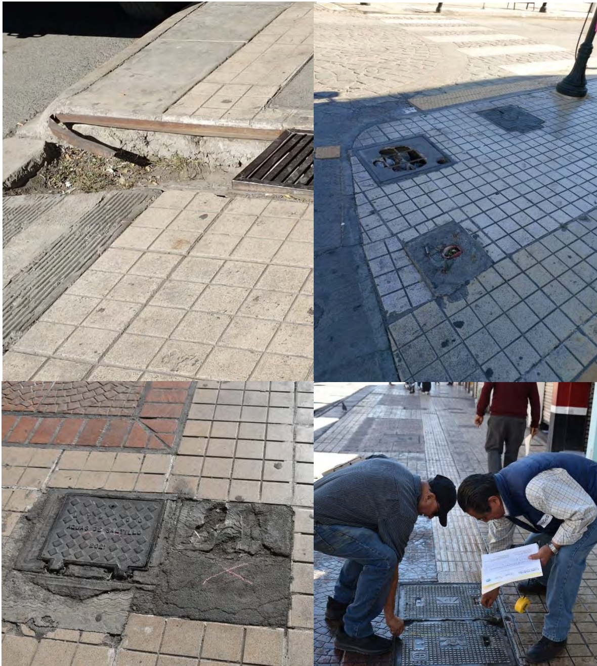
Imagen 12. Ejemplos de registros dañados detectados durante la caminata sobre la Calle Victoria.
