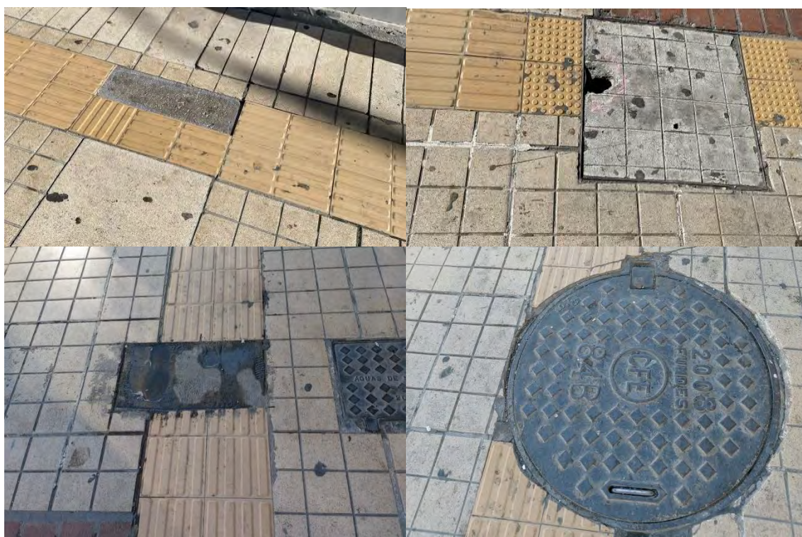
Imagen 7. Ejemplos de sitios en donde la guía podo táctil se encuentra dañada o interrumpida.
