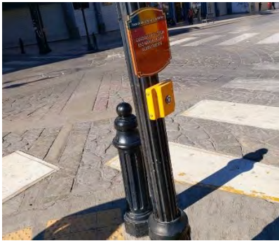
Imagen 10. Ejemplo de semáforo peatonal no funcional, en el cruce de Victoria y Manuel Acuña. Si bien presenta la existencia de un botón para permitir el paso de los peatones, este no es funcional.
