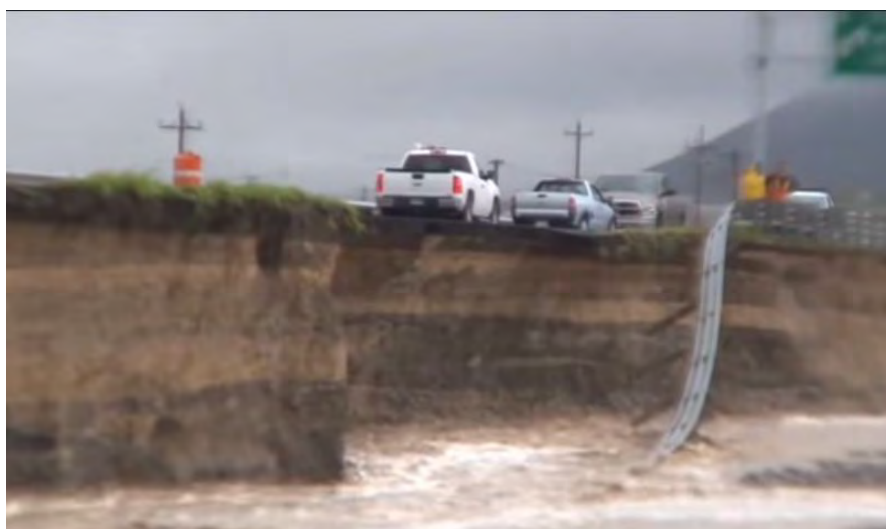
Ilustración 3. Afectaciones en la autopista Saltillo Monterrey, por el paso del huracán Alex. Fuente: Vanguardia
